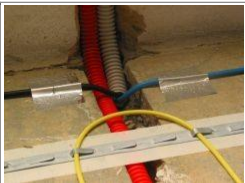
5- kabel v okolí drážky pro čidlo
