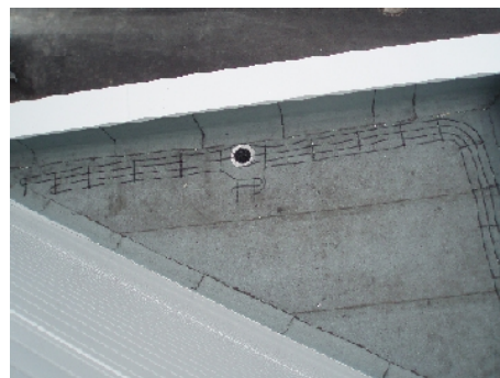
Topný kabel na okraji střechy a okolo střešní vpusti
