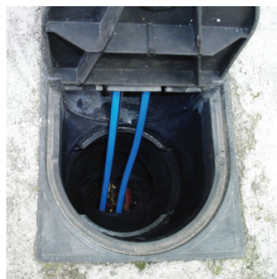
topné kabely ve vpusti
