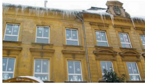
nebezpečné rampouchy u veřejných chodníků, základní škola, severní Čechy
