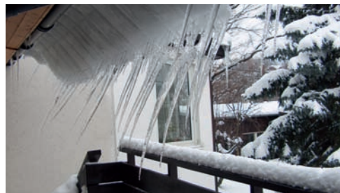
nepřechodné a přetížené okapové žlaby, Valašské Meziříčí
