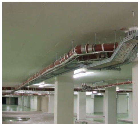
vyhřívání podstropní rozvody v nevytápěných podzemních prostorách, rezidenční komplex Central Park Praha
