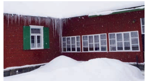
zátěží sněhu stržený okap (rohová část chybí), Dolní Dvůr
