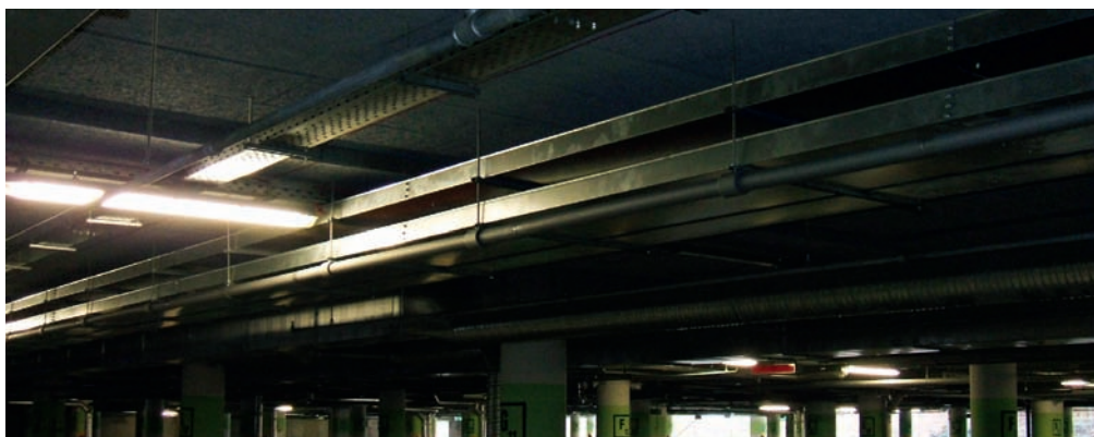
podstropní potrubní rozvody, podzemní garáže obchodního centra Plaza Novodvorská, Praha
