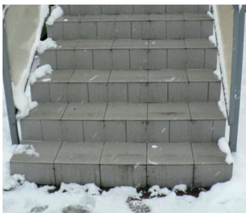
vyhřívání schodiště, Ostrava
